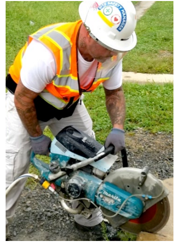
Aplicar agua a la hoja de una sierra mecánica manual reduce la cantidad de polvo que se crea al cortar.
