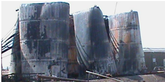
Figura 2: Tanques de almacenamiento dañados por el incidente de retroceso de llama de la antorcha.
