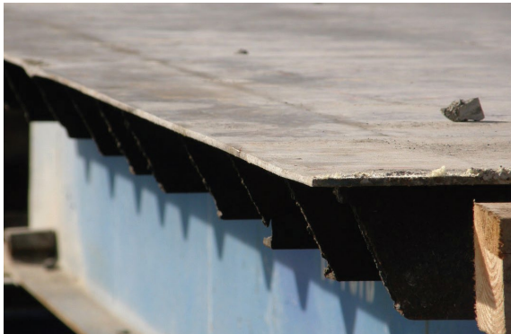
Imagen 2. Los bordes metálicos pueden cortar las líneas de vida y las cuerdas de seguridad.
