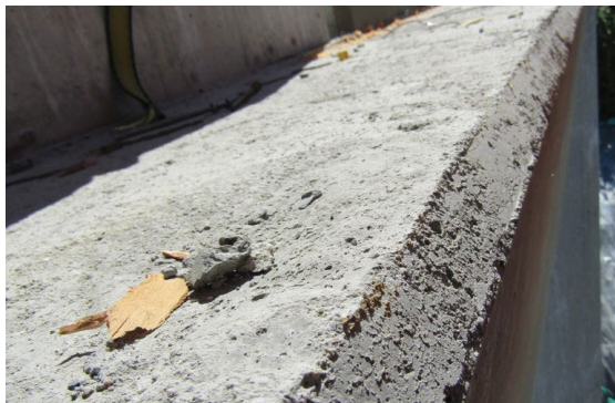
Imagen 3. Los bordes de concreto pueden cortar las líneas de vida y las cuerdas de seguridad.
