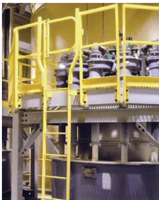
Plataforma elevada con guardarraíl de protección.
